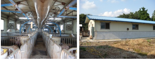
그림 11. 유비쿼터스 돈사관리시스템 설치 현장 Fig 11. Installation site of Ubiquitous swinery management system
