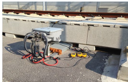
그림 2. 귀선전류 및 귀선전류 고조파 측정 사진 Fig. 2. Measured photo of return current and harmonic frequency
