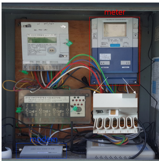
그림 9. 미터(자바카드) 및 모뎀 현장 설치 사진 Fig. 9. Meter(with java card) and modem installation picture
