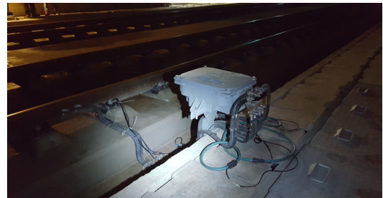
그림 2. 귀선전류 및 고조파 센서 설치 사진 Fig. 2. Measured photo of return current and harmonic frequency
