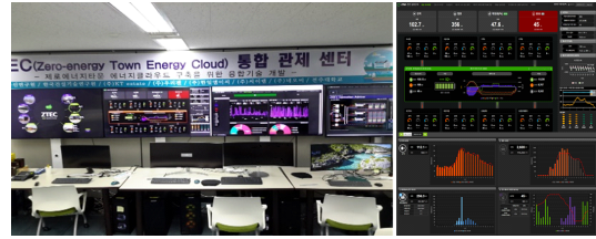
그림 18. 제로에너지타운 에너지클라우드 통합관제센터 기술 Fig. 18. ZTEC integrated control center technology
