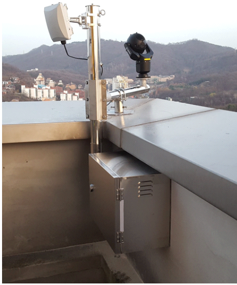
그림 9. 고층 광역 CCTV 설치 화면 Fig. 9. High-rise wide-angle CCTV installation screen
