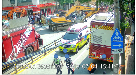
그림 3. 2018년 발생한 잠원동 붕괴사고 현장(후면) Fig. 3. The site of the collapse of Jamwon-dong(back side view)
